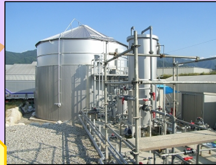
メタン発酵装置(新プラント)
